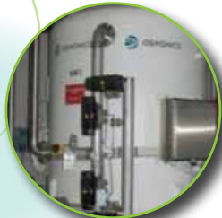
CCI Mersin fabrikası kum ve aktif karbon filtre sistemi
